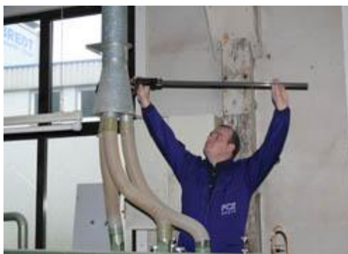
Hier sehen Sie den Messschieber bei einer Messung an einer Abluftanlage
