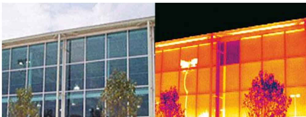
Die Infrarotinspektion entdeckt ein falsch eingebautes Glaselement. Die Beschichtung ist innen statt außen am Fenster angebracht.
