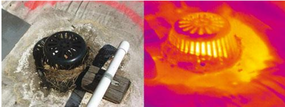
Das Infrarotbild zeigt Wasserlecks im Bereich der Eindichtung an der Dachentwässerung.
