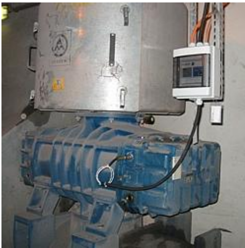
Hier sehen Sie den Vibrationsmonitor bei einer Überwachung an einer Rüttelmaschine
