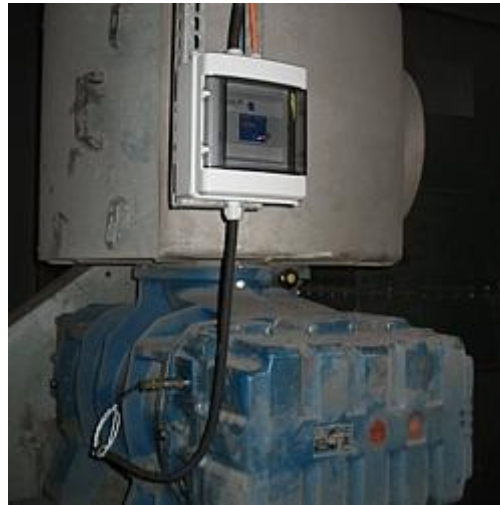
Hier sehen Sie einen Vibrationsaufnehmer bei einer Überwachung an einer Verdichtungsmaschine
