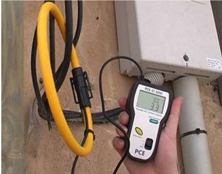
Stromzange PCE-EI-3000 bei einer Strommessung an einem Kabel
