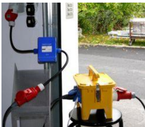
Unser mobiler Drehstromzähler Easycount vor einer Verteilerbox.
