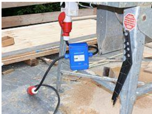
Mobiler Drehstromzähler Easycount auf einer Baustelle vor der Kreissäge.
