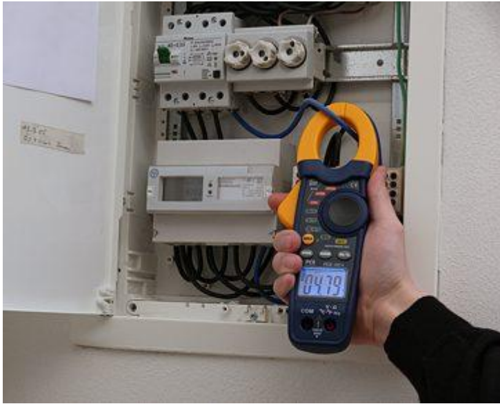
Messzange PCE-DC 4 bei der Messung des Stromes in einem Verteilerkasten.
