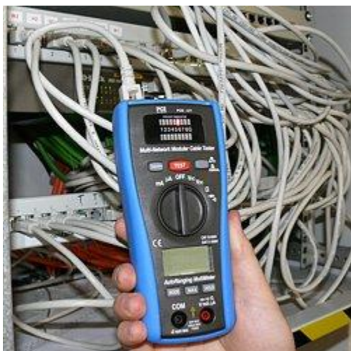
Tester bei der Fehlersuche im Netzwerk
