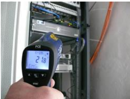
Infrarot-Thermometer bei der Messung am Schaltkasten
