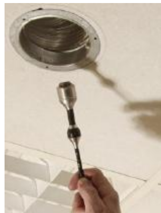
Lüftungskanäle können mit dem Endoskop untersucht und Schäden durch die Markierung an dem Schubkabel lokalisiert werden.
