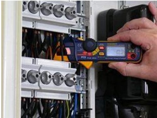
Amperemesser im Einsatz an einem Schaltschrank
